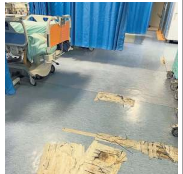
▲ I buchi Il pavimento del reparto rattoppato
