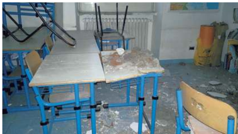
Sos scuole I calcinacci caduti sui banchi da un soffitto crollato
