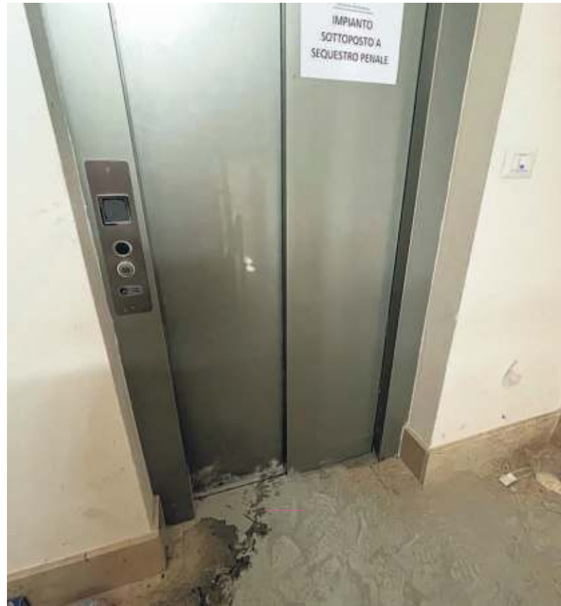
▲ A Brancaccio Il vano dell'ascensore precipitato in via Balistreri
