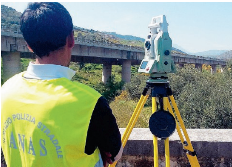
Viadotto Imera. Un sopralluogo dei tecnici dell'Anas dopo il crollo
