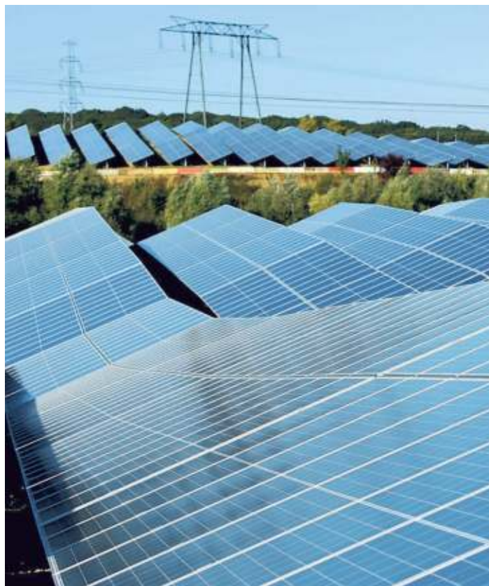
▲ Il piano Un impianto fotovoltaico
