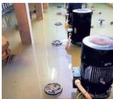
▲ I danni La condotta Bresciana a Trapani invasa dall'acqua e a destra la voragine che s'è aperta a Sciacca
