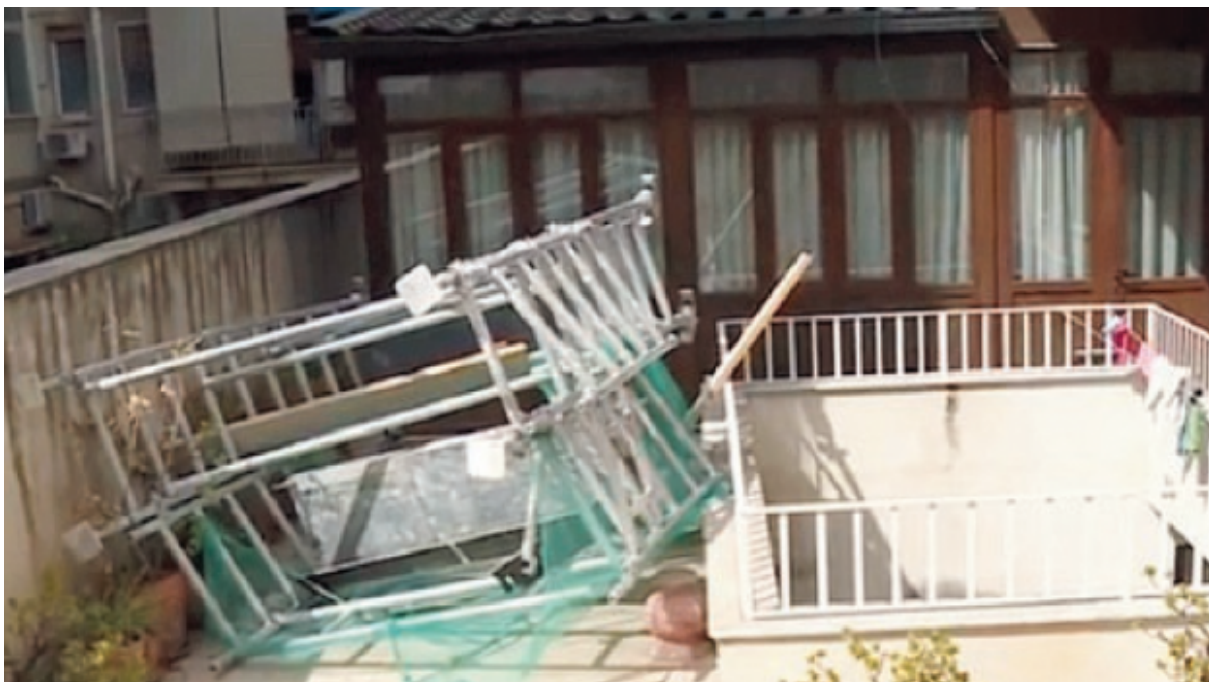
L'impalcatura crollata nel condominio di via Pirandello a Palermo
