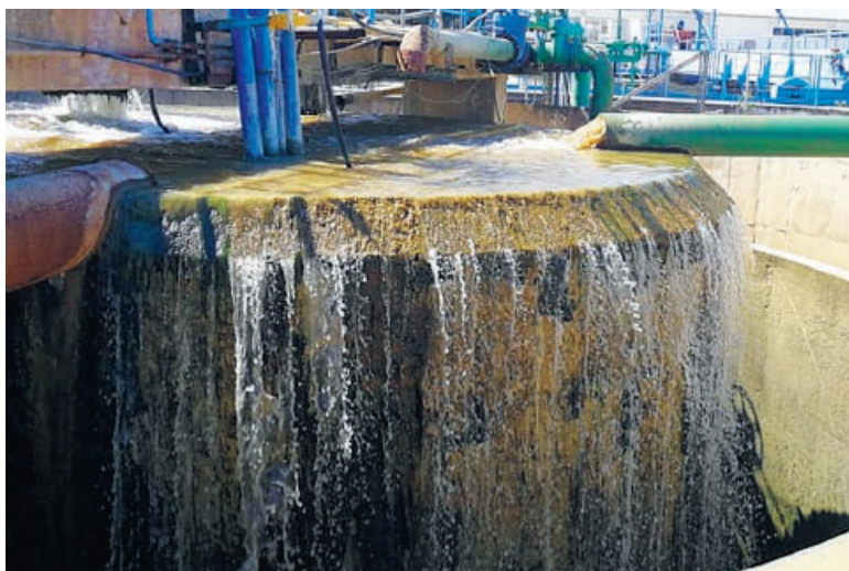
Serbatoio. Il problema è stato rilevato nell'impianto di Monte Grifone
