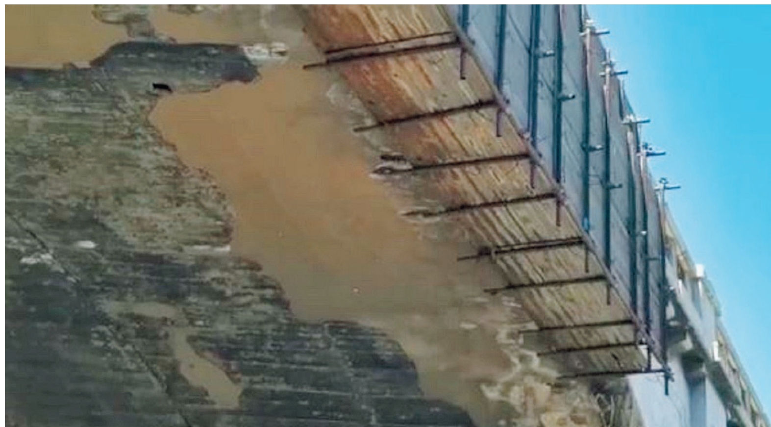
Un ponte ammalorato. La struttura sull'Oreto rivela tutti i suoi problemi e i suoi anni
